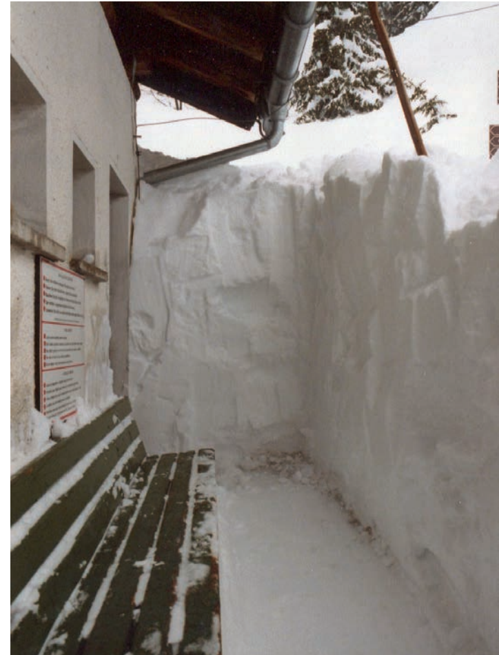
Das Gebäude ist bis unter das Dach eingefüllt.
